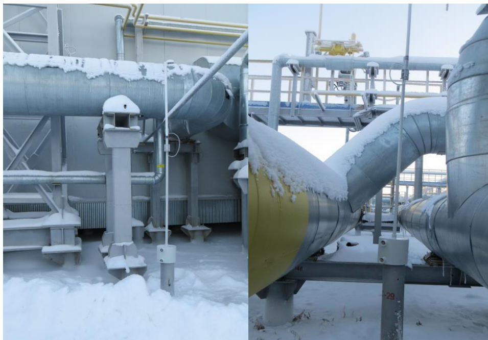
Рис. 11 – Дожимная компрессорная станция Медвежьего НГКМ
