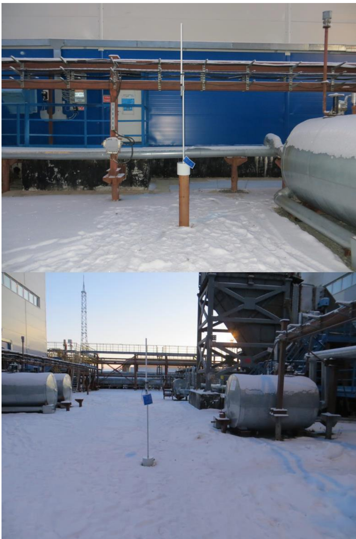
Рис. 12 - Дожимная компрессорная станция Юбилейного НГКМ
