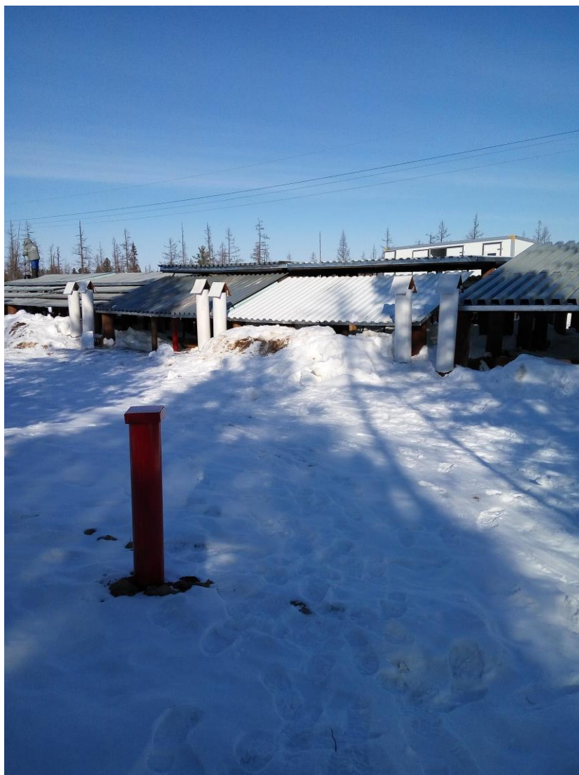
Рис. 8 – Размещенные навесы, термометрические скважины и датчики теплового потока подземного нефтепровода
