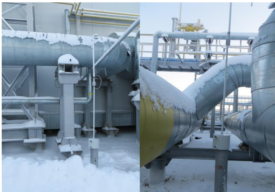
Рис. 1 – Дожимная компрессорная станция Медвежьего НГКМ
