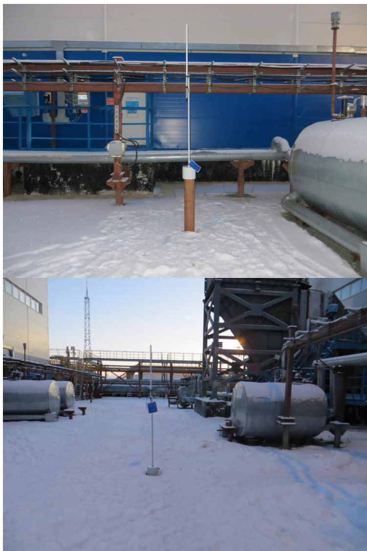
Рис. 2 - Дожимная компрессорная станция Юбилейного НГКМ
